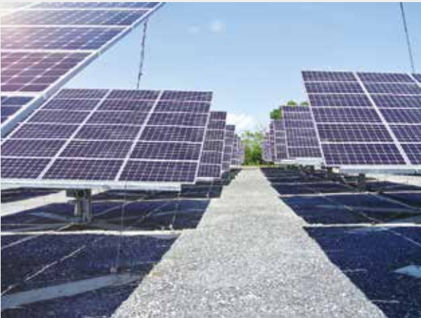
Japan Okayama Power Plant 日本冈山电站 Capacity 系统容量 : 499 kW Completed 完工年份 : 2014 Product 产品型号 : iPV Tracker T6024
