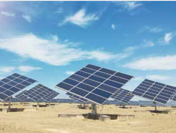
Xinjiang TBEA Power Plant 新疆柳树泉特变电站 Capacity 系统容量 : 132 kW Completed 完工年份 : 2015 Product 产品型号 : iPV Tracker T6024
