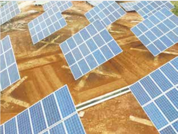
Jiangxi AKCOME Power Plant 江西赣州爱康电站 Capacity 系统容量 : 80 kW Completed 完工年份 : 2016 Product 产品型号 : iPV Tracker T6024
